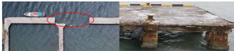
Gambar 3. Kerusakan Segmen Dermaga Sumber: Survei Lapangan (2023)
