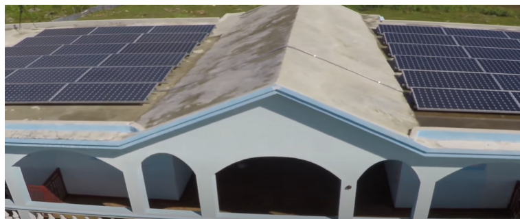
Gambar 4. Penerapan panel surya pada atap panti asuhan untuk efisiensi energi. Sumber: Freedom Solar Power (2018) [35]
